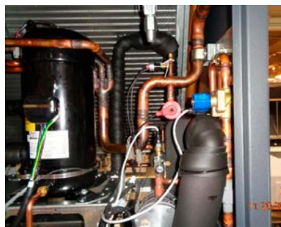
实际安装的舒瑞普 Q80ASx60 钎焊板式换热器（带隔热层）。
