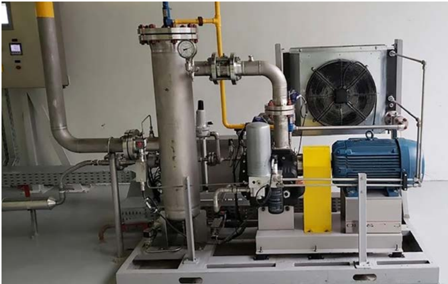
采用舒瑞普 B10T All-Stainless 钎焊板式换热器的沼气系统。
